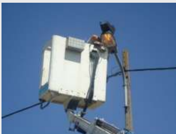
Primeiro Balastro com RFL instalado em Sousel
