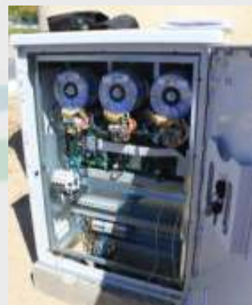
Primeiro Armário com RFL instalado em Portalegre
